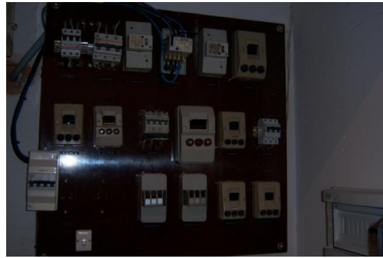
Detalle de Cuadro deteriorado e incorrecto
