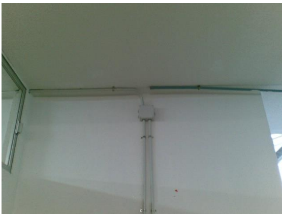
Detalle de canalización defectuosa y mal anclada
