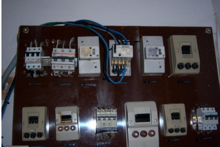
Cuadro General de Mando y Protección
