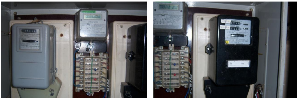
Detalle de contadores
