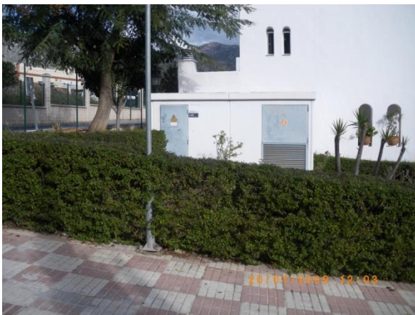
Centro de transformación próximo al Centro
