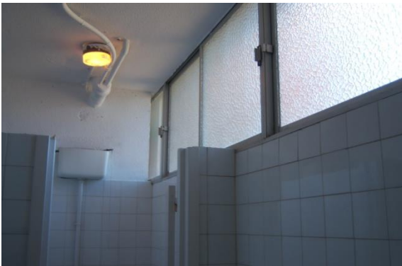
Detalle de punto de luz mal ubicado
