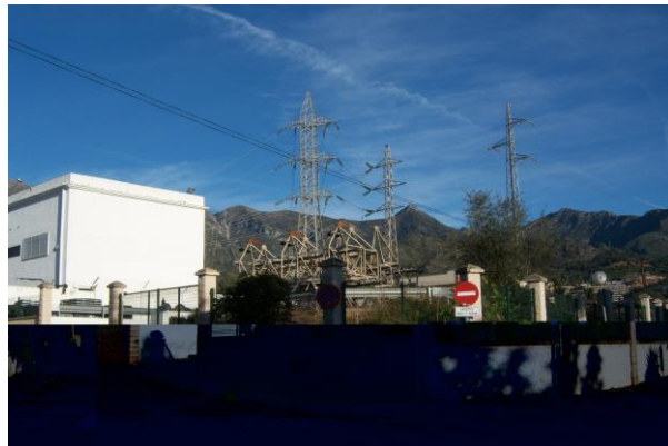
Subestación Eléctrica (Calle del Almendro)
