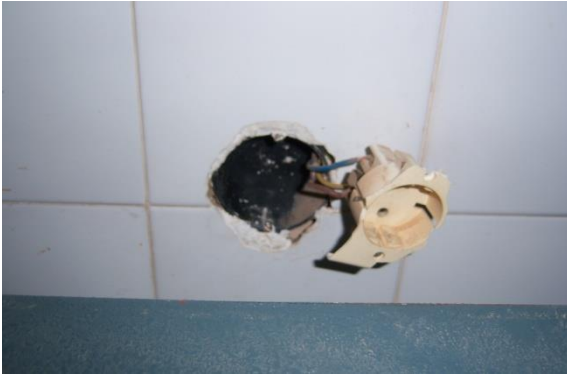
Detalle de toma de corriente defectuosa
