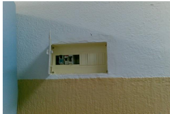
Detalle de interruptores de protección defectuosos
