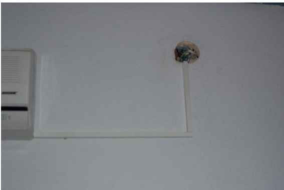
Detalle de Caja de Conexión sin tapa
