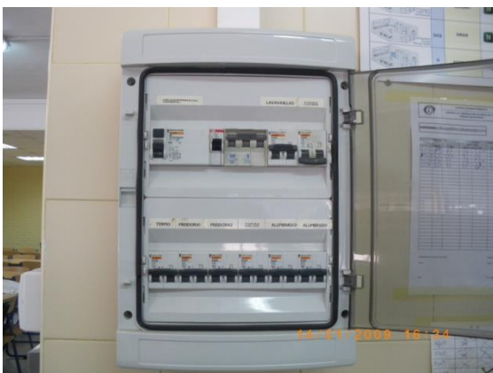
Detalle de Cuadro Secundario de Cocina
